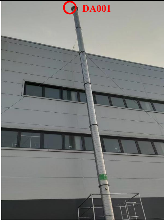
车间 21m 高排气筒 (DA001)
