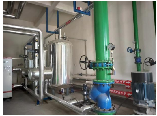
水处理及热交换站内
