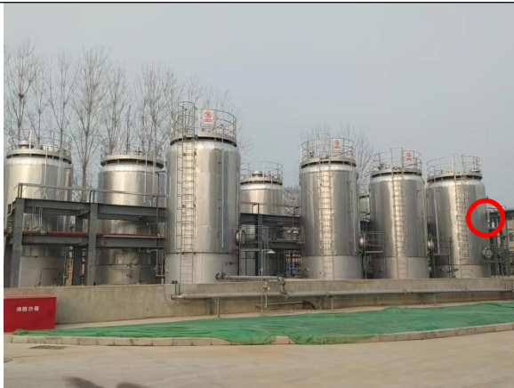
储罐呼吸口集气管道
